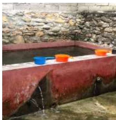
Gambar 4. Bak Kamar bilas bocor Sumber Data : Dokumen Pribadi
